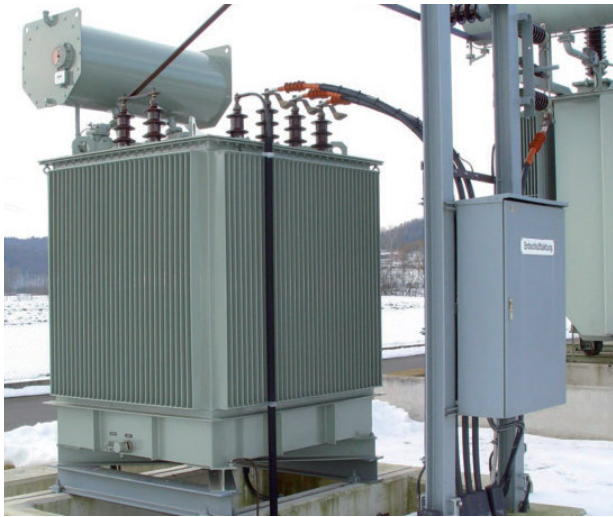
Рис. 9. Заземляющий дугогасящий агрегат 10 кВ / 160 А для продолжительного режима работы (производство компании TRENCH, Австрия)
