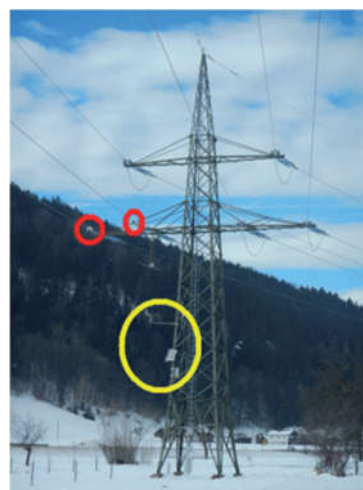
Рис. 4. Лінії електропередачі з двома ОТЛМ модулями на проводах підвісних ізоляторів траверс (маленькі кола) і метеостанція на стійці анкерної опори (велике коло)
