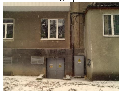
Рис. 1. Житловий будинок старої забудови із вбудованою трансформаторною підстанцією
