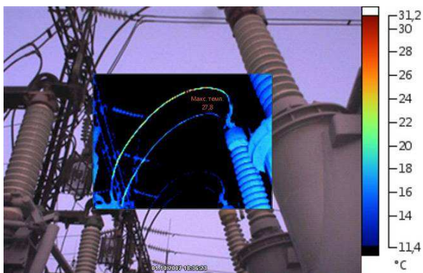
Рис. 6. Результаты тепловизионного контроля контактных соединений на створе НН трансформатора ПС ""Шахта-21" Т-2".
