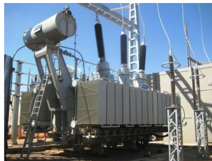
Рис. 1. Автотрансформатор типу АТДЦТН-125000/330/110, виробництва ВАТ «Запоріжтрансформатор» (м. Запоріжжя)
