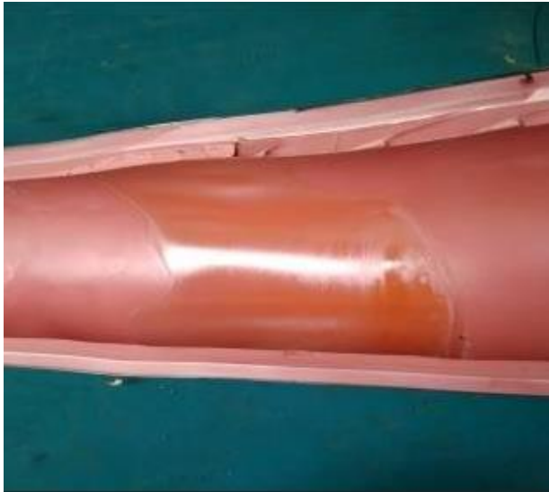
Рис. 1. Зображення дефектної з'єднувальної муфти кабелю 35 кВ після випробування: на коричневій ізоляційній трубці помітні сліди "маслянистого" нальоту (продукти розкладу полімеру) внаслідок часткових розрядів в інтерфейсному повітряному зазорі [4]
